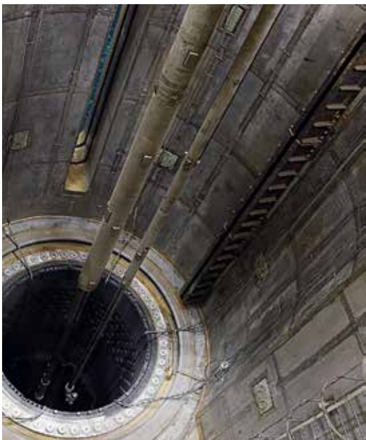
Нововоронежская АЭС-2. Физический пуск энергоблока № 2, загрузка ТВС
