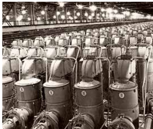
Цех газодиффузионных машин
