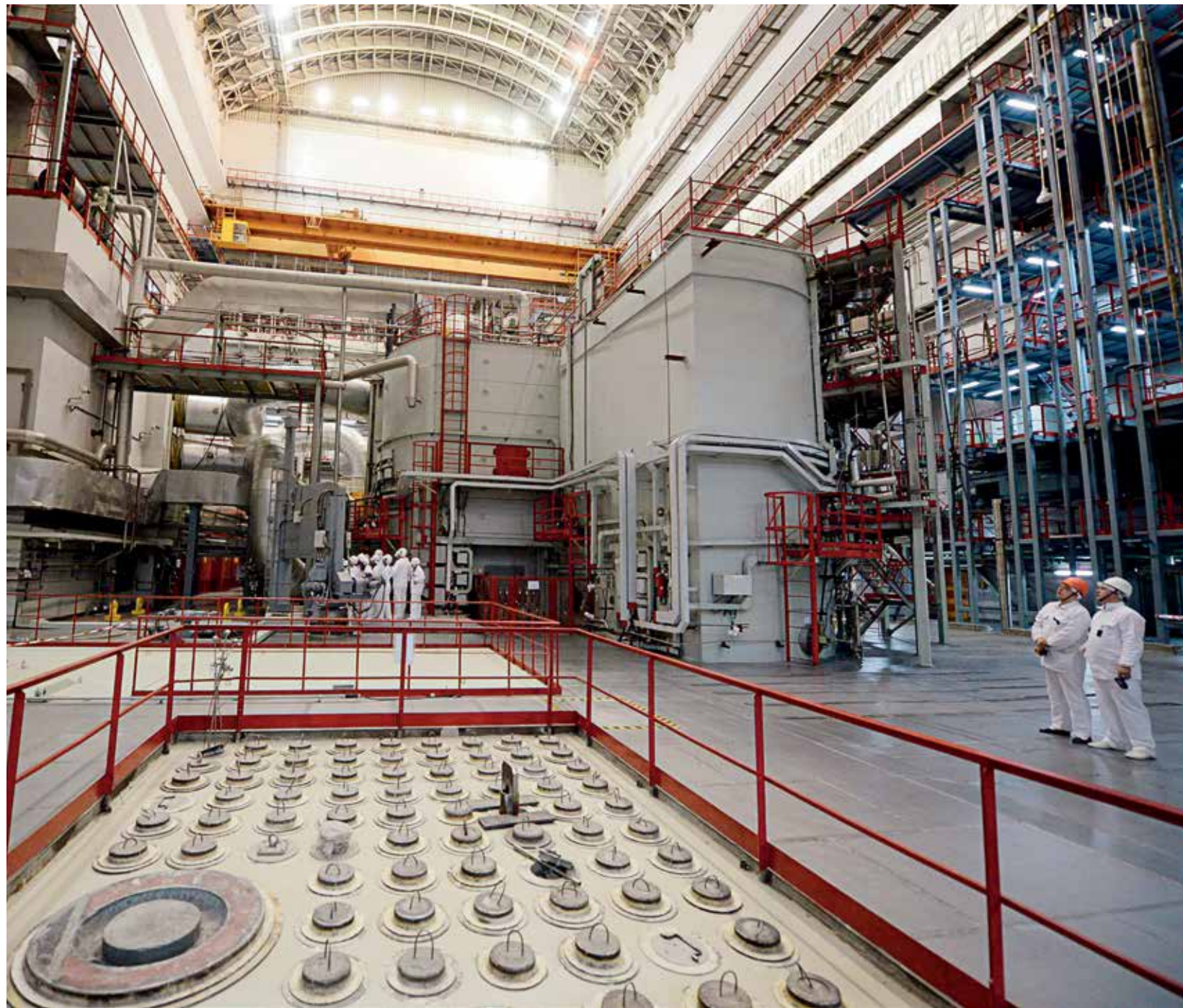
Центральный зал 4-го энергоблока с реактором БН-800 Белоярской атомной электростанции
